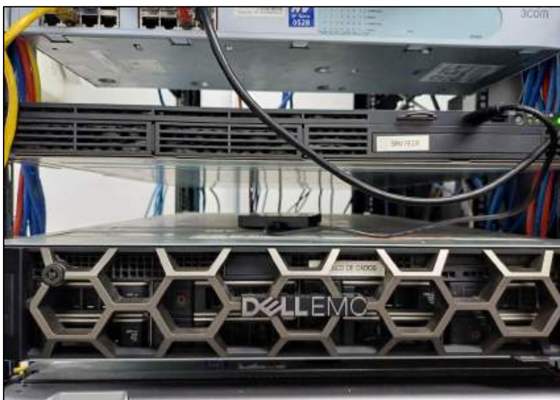
ITEM 090 - RACK COM SERVIDORES, CPU, MONITORES, SWITCHES
