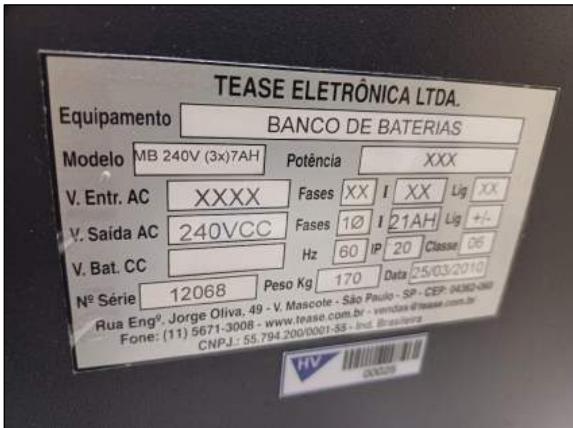
ITEM 088 - BANCOS DE BATERIAS TEASE
