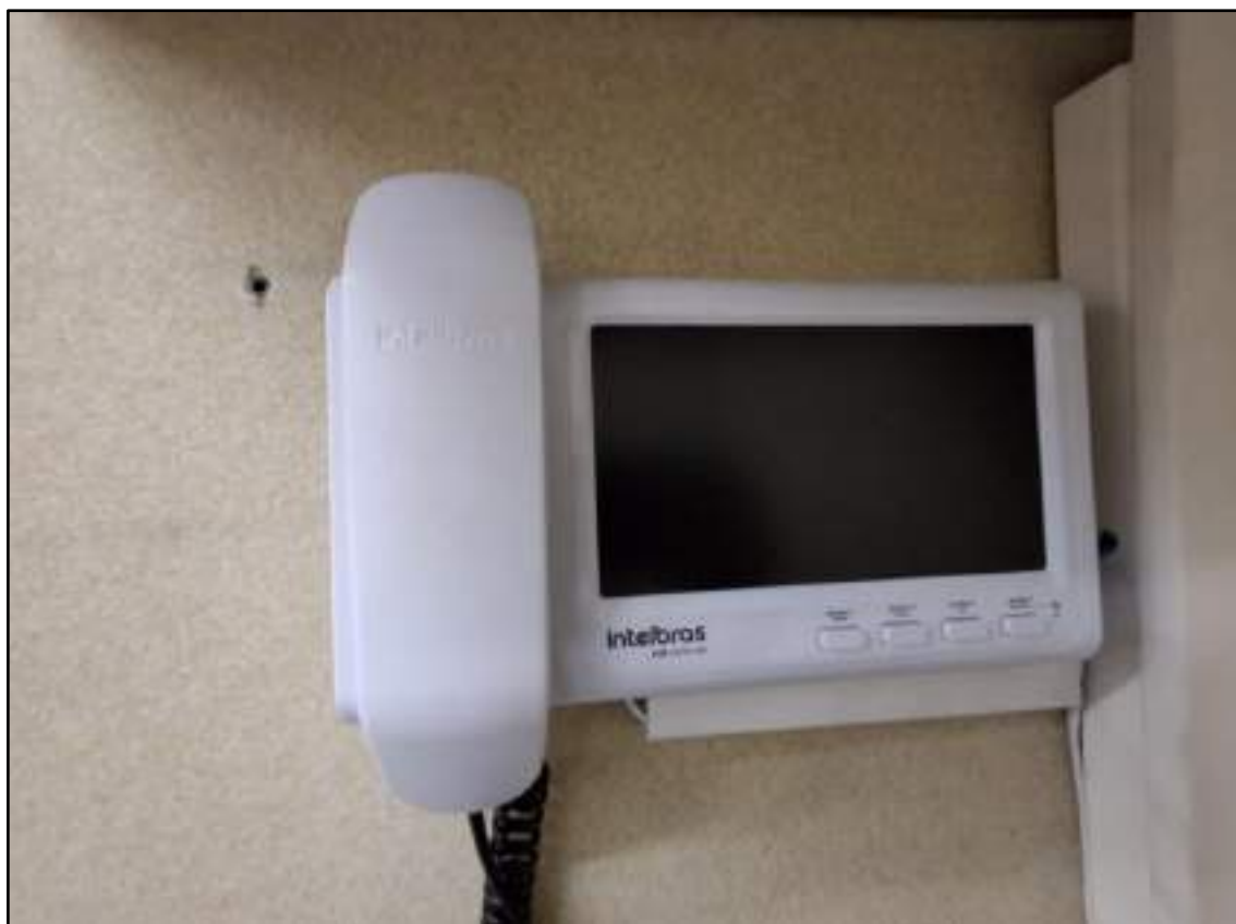
ITEM 031 - INTERFONE INTELBRAS
