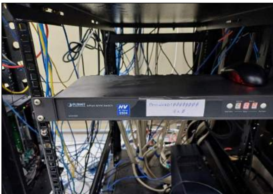
ITEM 090 - RACK COM SERVIDORES, CPU, MONITORES, SWITCHES
