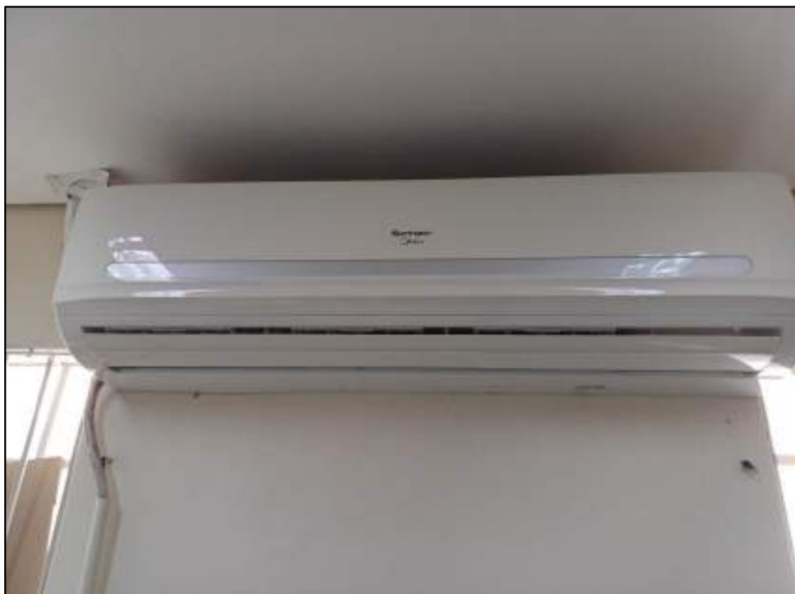
ITEM 083 - AR CONDICIONADO SPRINGER
