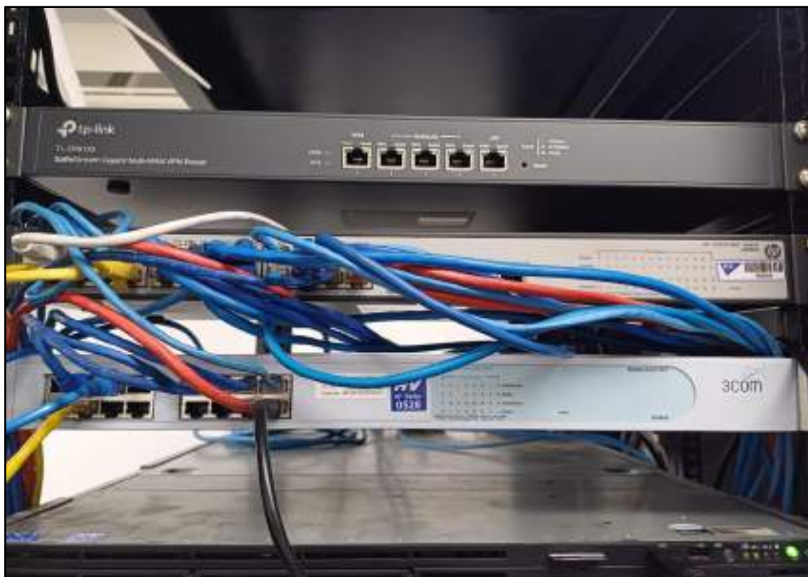
ITEM 090 - RACK COM SERVIDORES, CPU, MONITORES, SWITCHES
