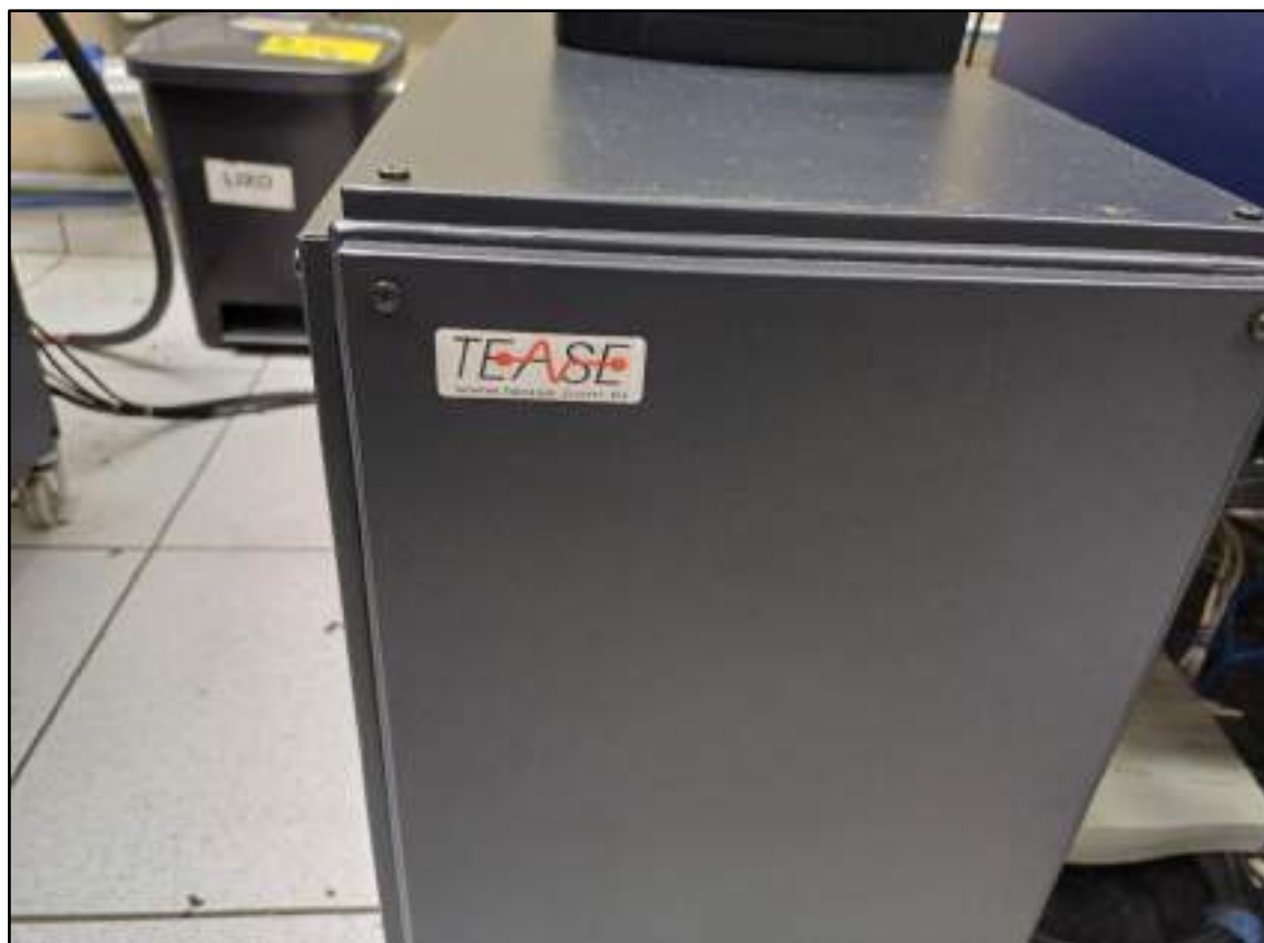
ITEM 088 - BANCOS DE BATERIAS TEASE
