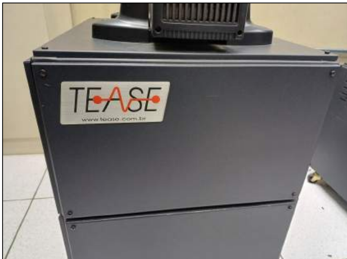
ITEM 088 - BANCOS DE BATERIAS TEASE
