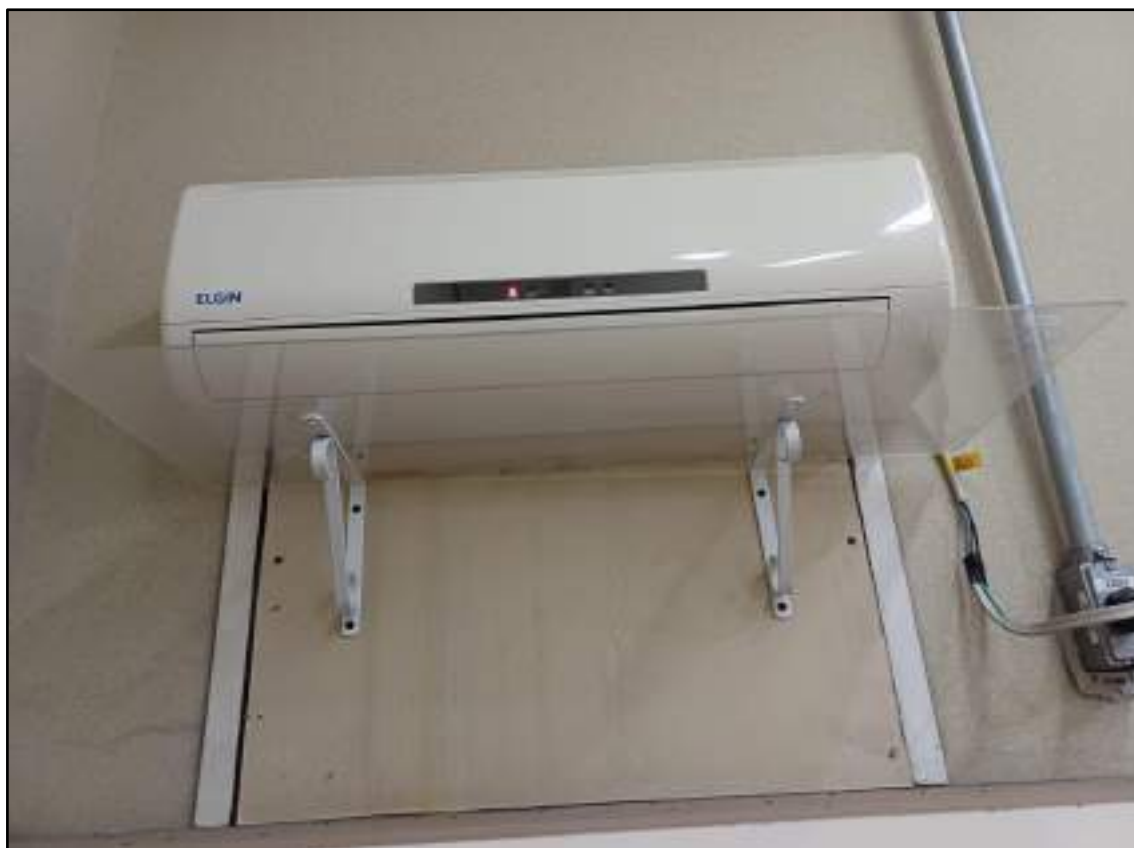
ITEM 069 - AR CONDICIONADO ELGIN
