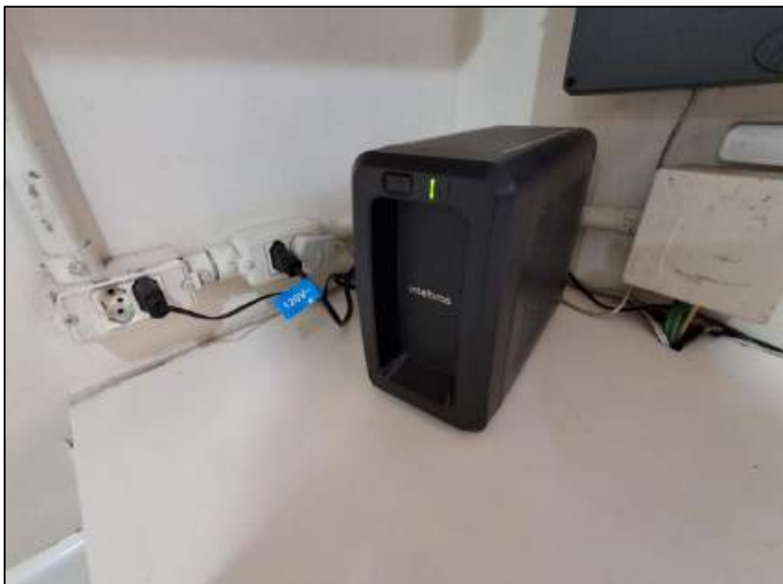
ITEM 164 - ESTABILIZADOR INTELBRAS
