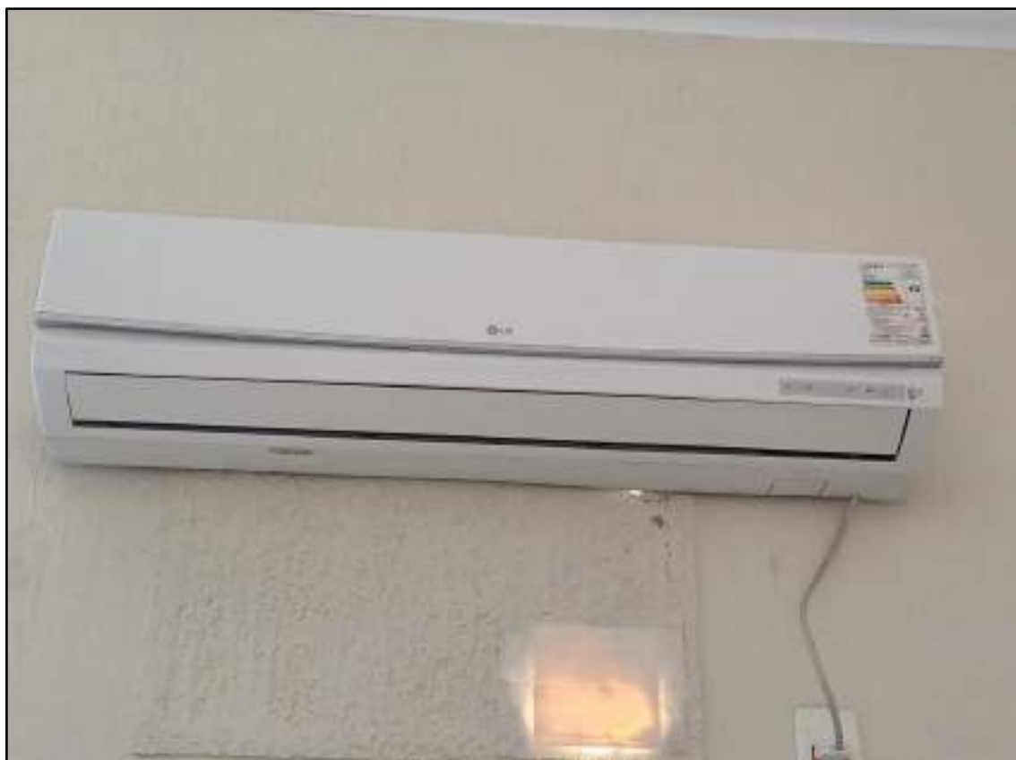
ITEM 001 - AR CONDICIONADO LG
