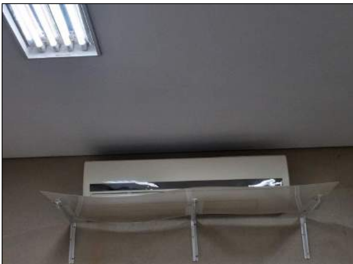
ITEM 139 - AR CONDICIONADO ELGIN
