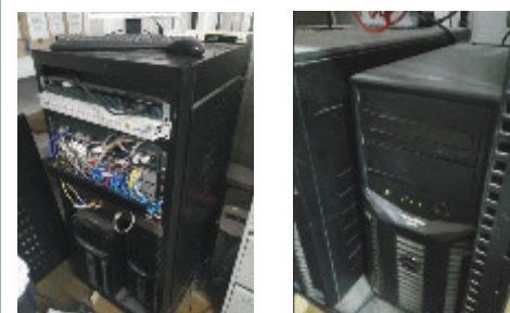
01 – Conjunto de Armário de Rede e 02 Servidores Power Edge
