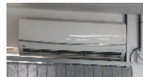
01 - Ar Condicionado LG
