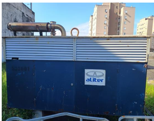
Vista geral dos Equipamentos
