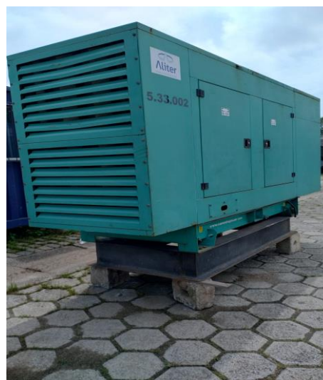
Vista geral do Gerador
