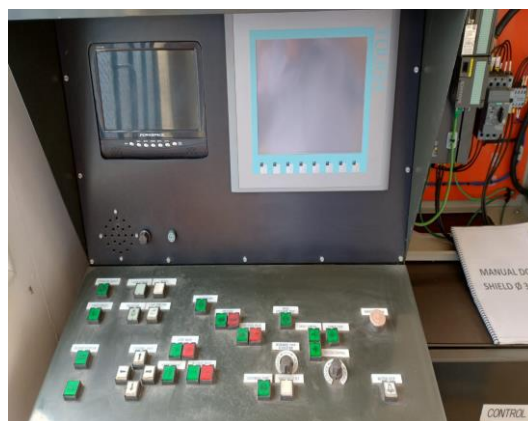
Vista Cabine da Tuneladora
