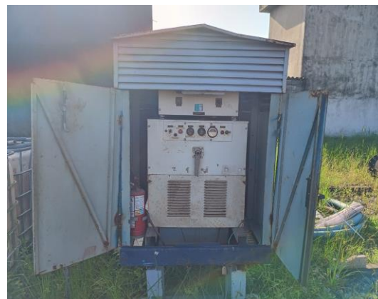
Vista geral dos Equipamentos
