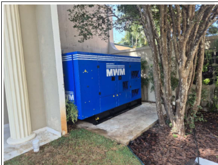
(Figura 7 - gerador de energia)
