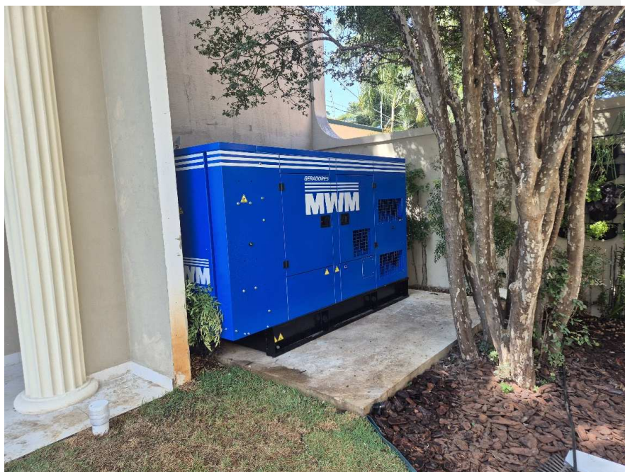
Fotografia 23 – Aspecto externo do imóvel avaliado (gerador de energia).
