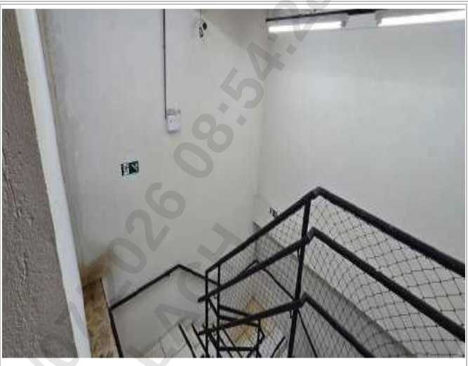
ESCADA DE INCÊNCIO
