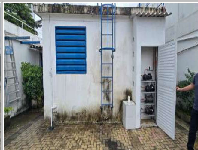
CASA DE BOMBAS
