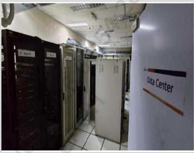
SALA DATA CENTER
